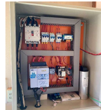
Figura 13 - Quadro de comando
