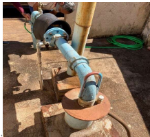
Figura 10 – Dispositivos: Tubo medidor de nível, laje de proteção sanitária.
