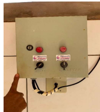
Figura 22 -Quadro de comando
