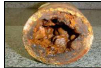
Figura 45 - Ilustração de secção de tubulação incrustada
