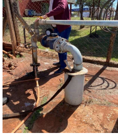
Figura 4 - Dispositivos: laje de proteção sanitária e tubo para medição de nível.
