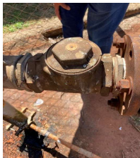
Figura 6 - Válvula de retenção no cavalete de recalque.
