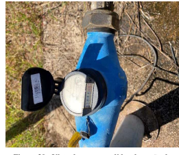
Figura 30 - Vista do macromedidor de vazão dos volumes captados.
