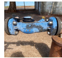
Figura 20 - Detalhe do Medidor Woltmann (quebrado).
