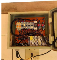
Figura 21 – Quadro de comando
