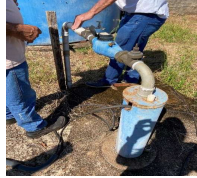
Figura 28 - Dispositivo: Laje de proteção sanitária e tubo medidor de nível.
