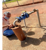
Figura 17 - Dispositivos, tubo de medição de nível, laje de proteção sanitária.
